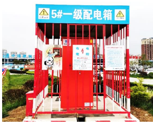
配电箱防护棚
