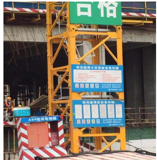
塔吊安全标志
