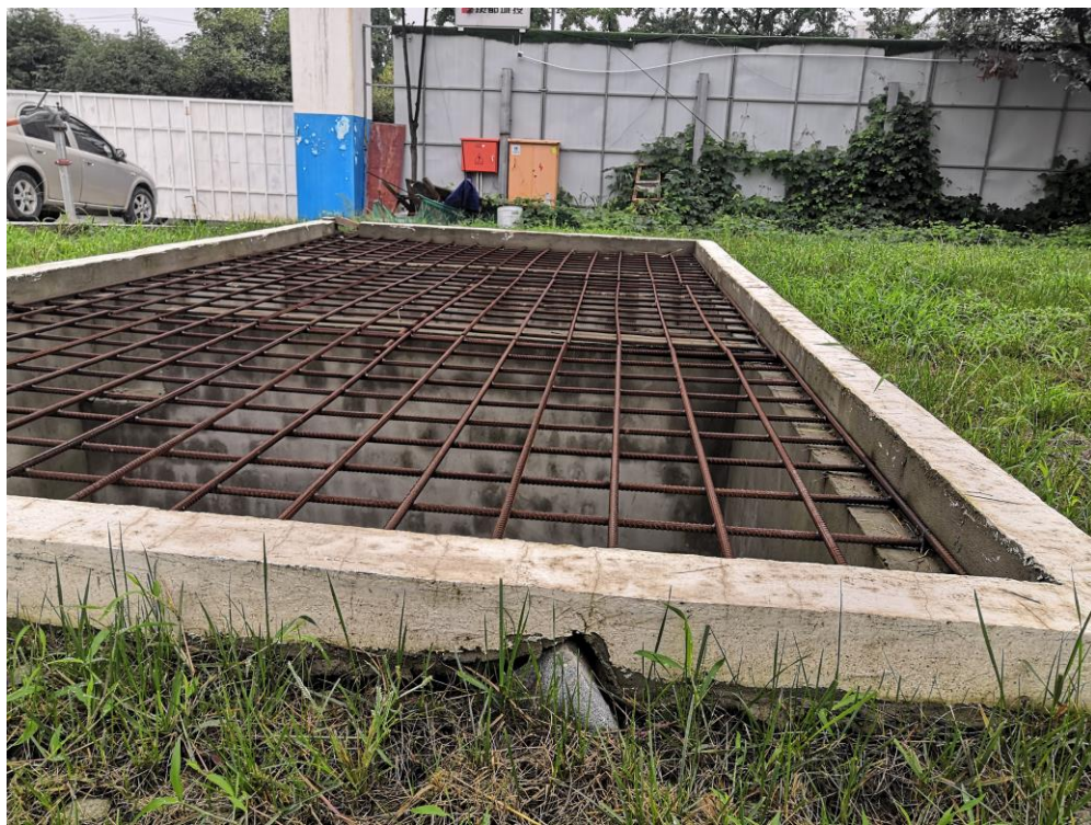
洗车池三级沉淀池
