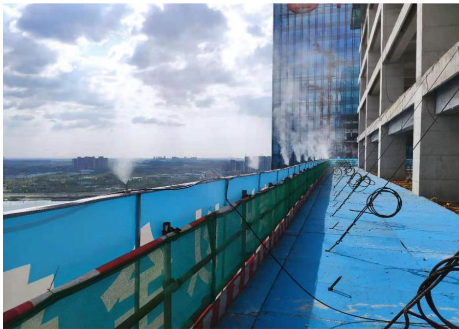
楼层降尘系统
