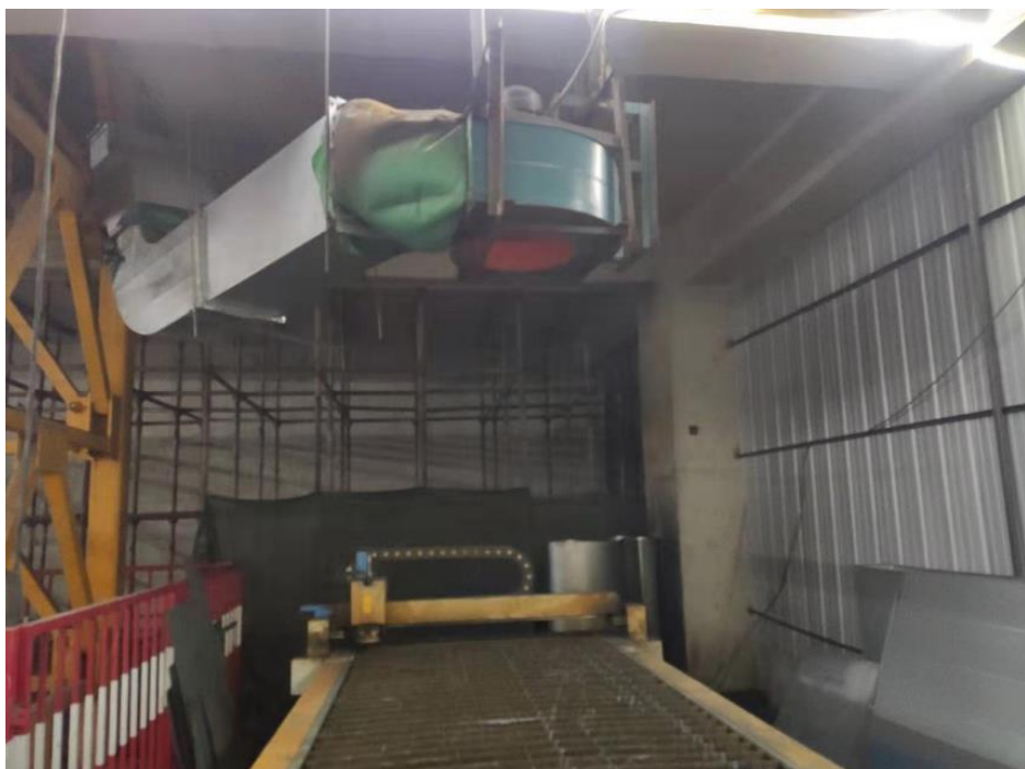
粉尘废气收集装置
