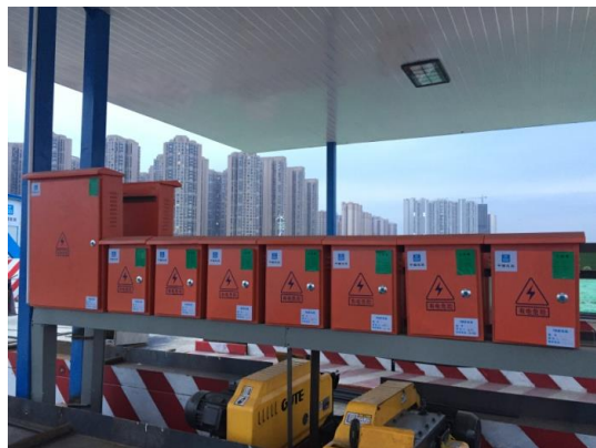
钢筋加工棚配电箱
