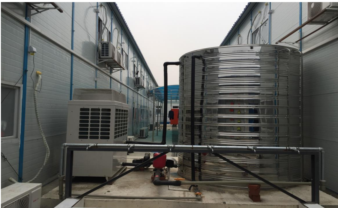
空气能热泵系统
