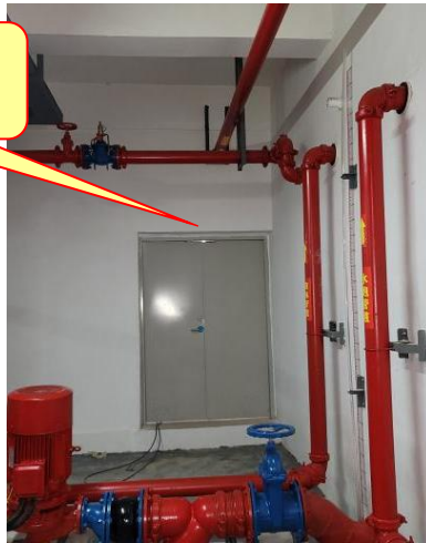
未安装应急照明 和疏散指示标志
