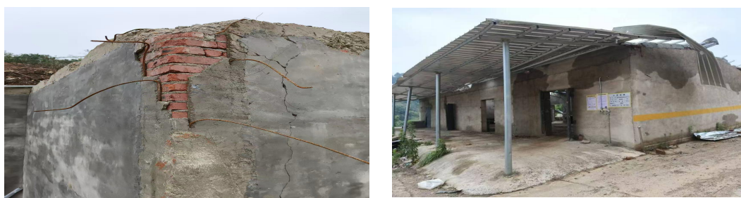
图 4 工房砌体承重结构、工房框架结构围墙无钢筋
