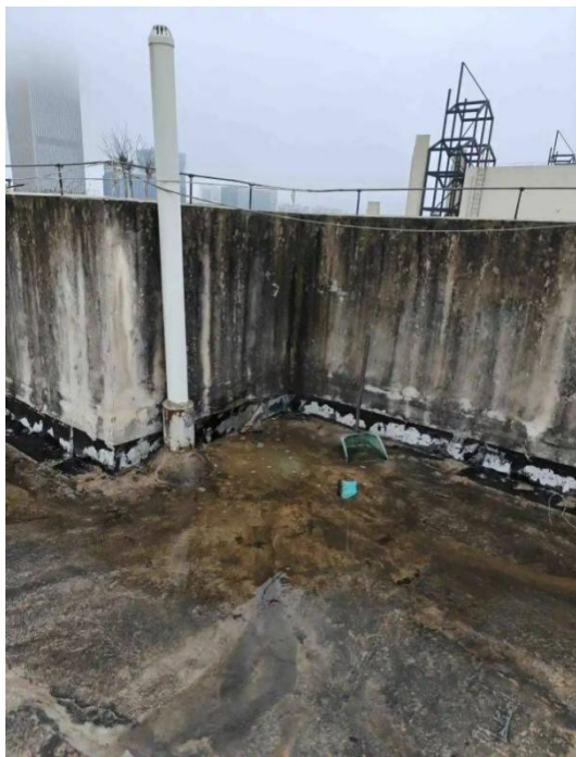
图 6.1.1-1 雨水口堵塞积水
