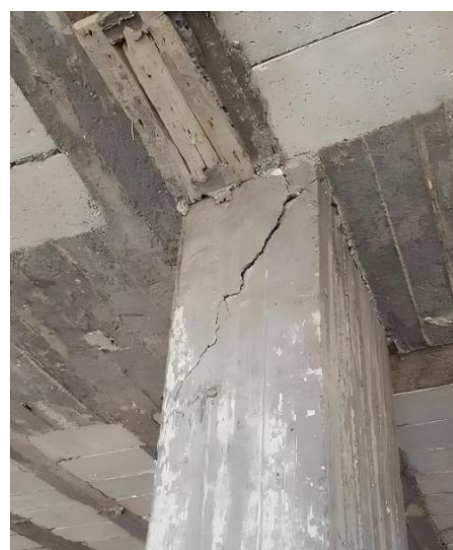
图 4.1.3-2 柱斜向剪切裂缝
