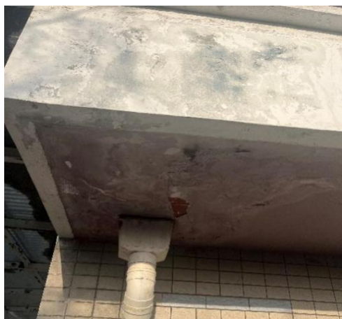
图 7.2.1-3 屋面天沟渗漏
