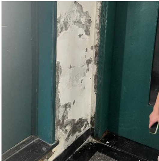
图 7.5.3-1 室内墙体涂料脱落
