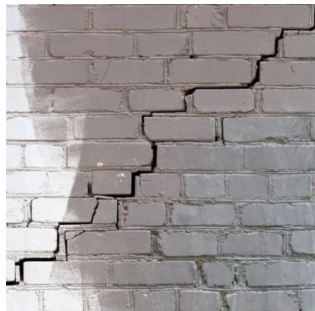
图 4.4.3-2 填充墙墙体斜向裂缝
