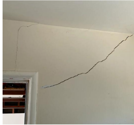
图 8.3.2-2 门洞口角部裂缝
