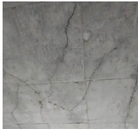
图 4.1.1-2 板不规则裂缝
