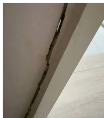
图 4.4.4-2 隔墙门框部位裂缝
