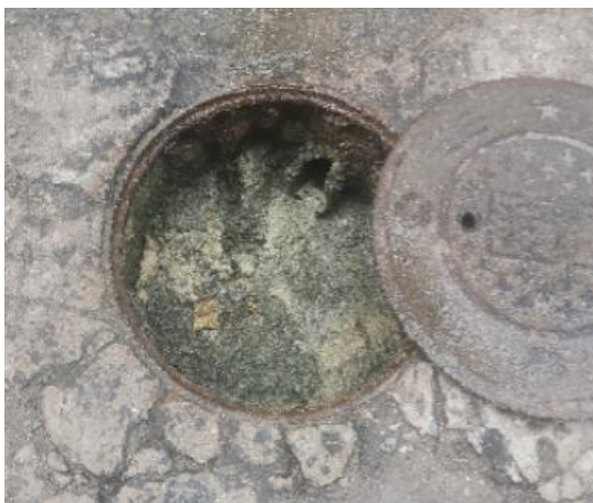
图 6.4.3-1 室外污水井堵塞溢水
