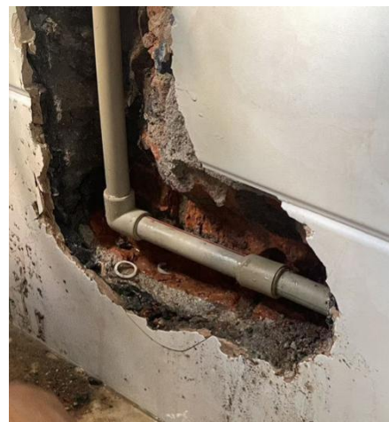
图 9.3.1-2 水管渗漏返臭
