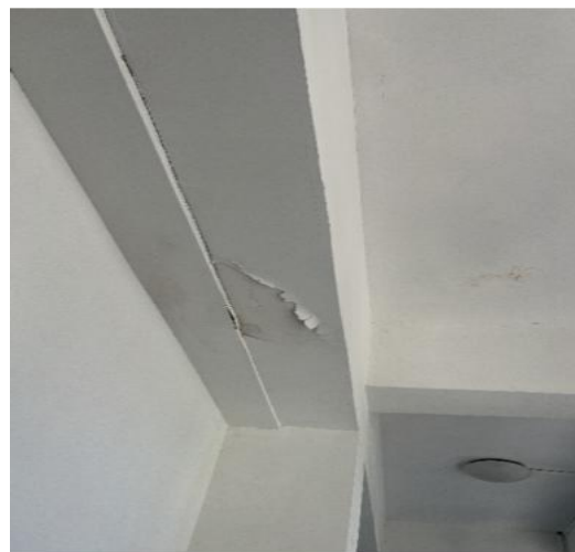
图 7.2.1-2 屋面变形缝渗漏
