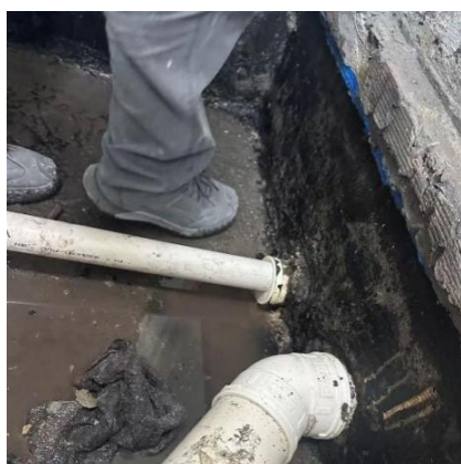
图 7.4-1 下沉式卫生间管道口渗漏
