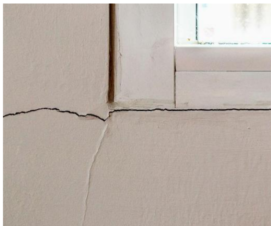
图 4.4.2-1 窗洞口角部裂缝
