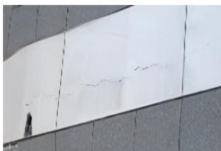
图 4.7.1-1 预制构件拼接裂缝
