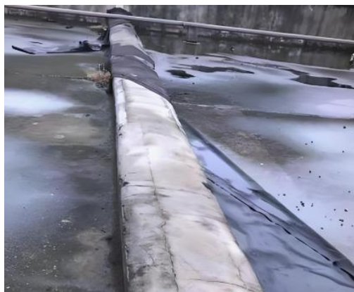
图 4.3.2-1 屋面变形缝裂缝
