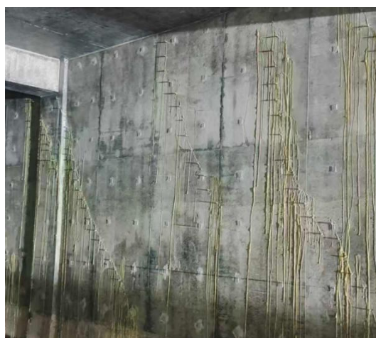
图 4.1.4-1 剪力墙斜裂缝
