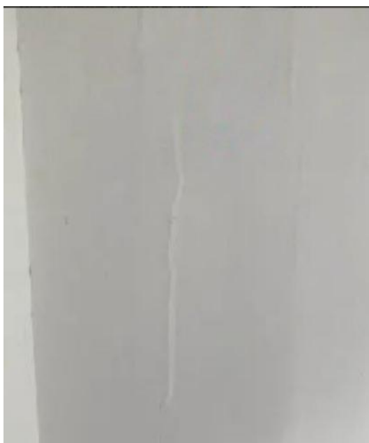
图 8.4.1-1 管线开槽部位抹灰层裂缝
