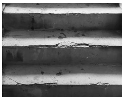
图 4.6.3-2 踏步饰面空鼓脱落
