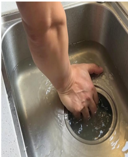
图 2.2.1-1 厨房水槽堵塞
