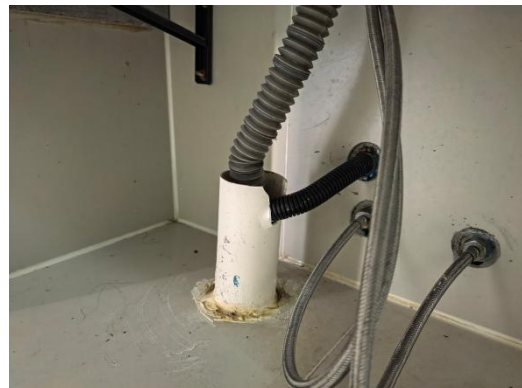
图 5.2.1-2 空调凝结水排入污水管
