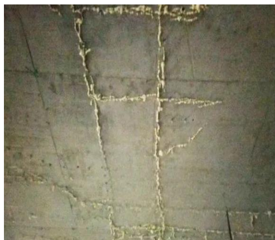
图 4.2.3-1 结构顶板裂缝
