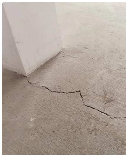
图 4.5.7-1 混凝土地坪裂缝
