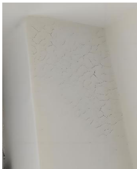
图 4.5.3-2 涂料饰面层龟裂
