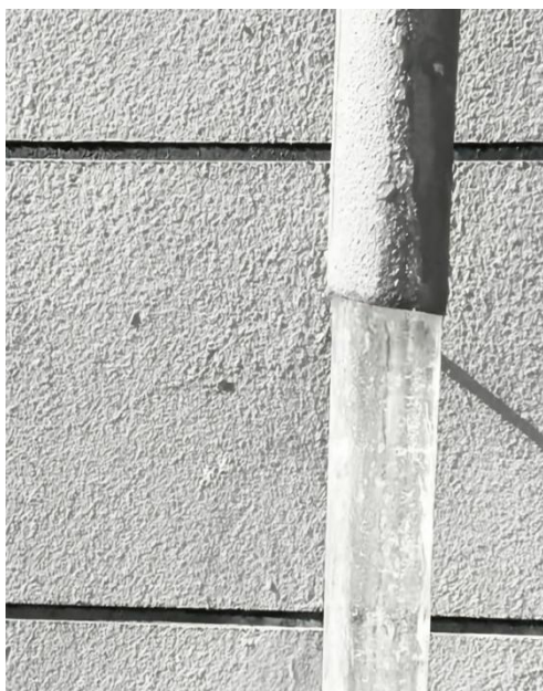
图 2.1.2-1 室外排水管冻塞
