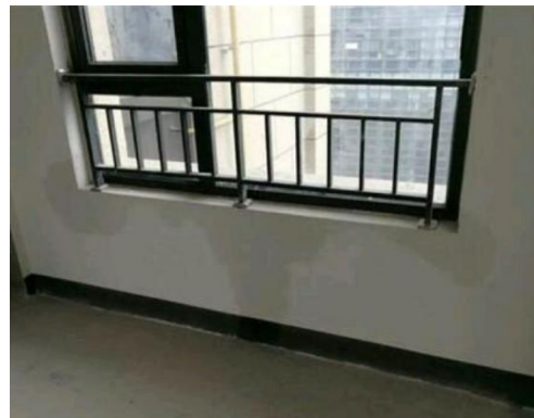
图 3.2.1-2 外窗框边渗漏
