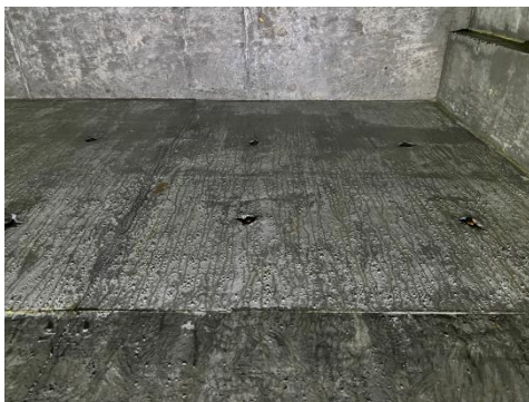
图 3.6.1-1 地下室结构墙面结露
