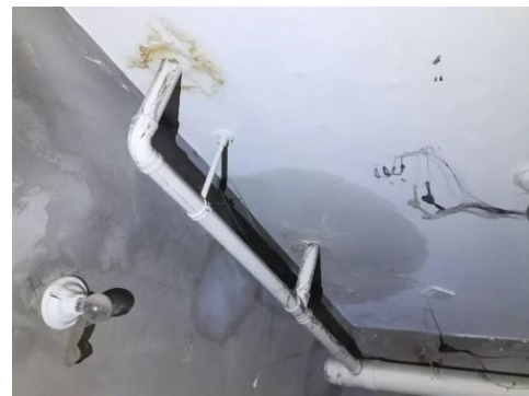
图 3.5.1-2 穿楼板管根渗漏
