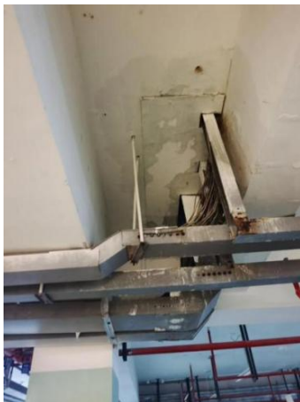
图 6.3.2-1 地下室线缆周边雨水倒灌
