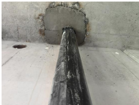
图 3.3.3-1 出屋面管道二次封堵渗漏
