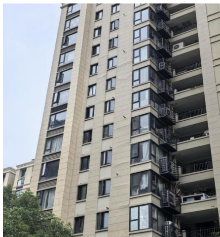
图 8.4.7-1 贴外墙附设管井与墙体交接处裂缝（整体）
