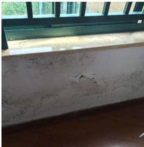
图 7.3-1 窗框下部墙体渗漏
