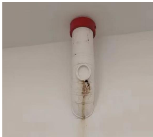
图 5.1.4-2 立管检查口渗漏
