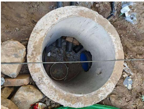
图 3.5.4-1 管道进检查井部位未封堵
