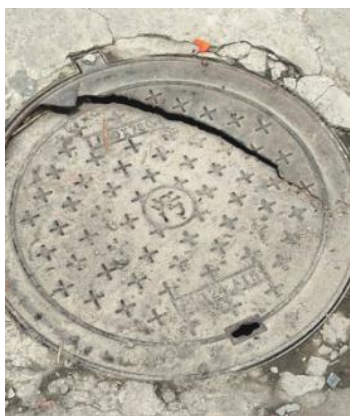
图 5.3.2-1 污水井井盖破损
