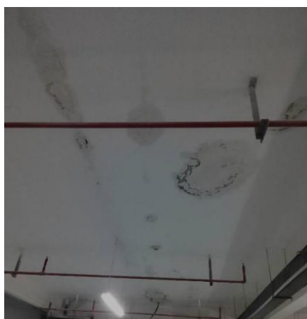
图 7.1.3-1 地下室顶板渗漏
