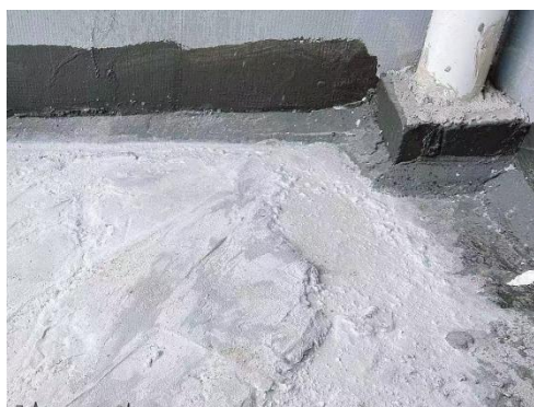
图 3.1.4-1 防水基层处理不到位
