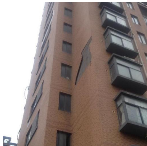
图 7.3-2 外饰面砖破损渗漏
