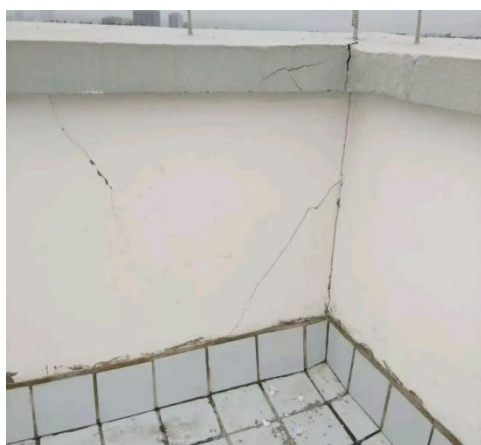
图 4.3.5-1 屋面女儿墙裂缝
