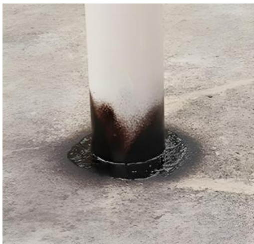
图 4.3.3-1 出屋面管道部位裂缝
