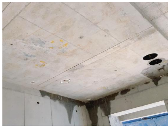
图 3.1.1-2 涉水房间结构板边渗漏
