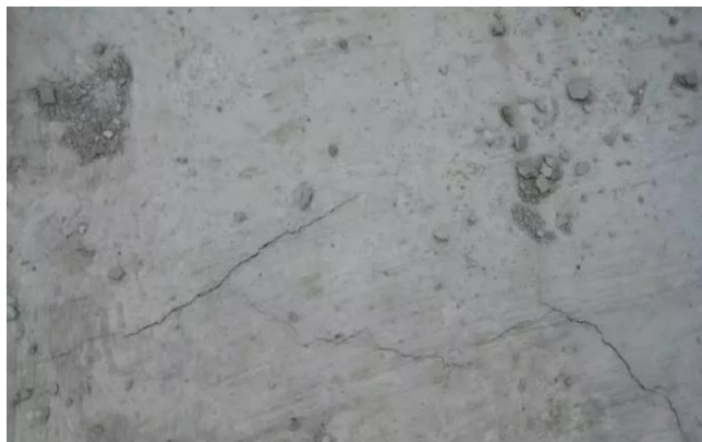
图 4.3.4-1 屋面地坪裂缝
