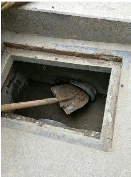
图 2.3.1-1 雨水井内泥沙淤积
