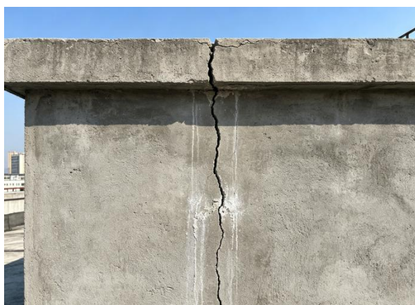
图 4.3.5-2 屋面女儿墙墙身开裂
