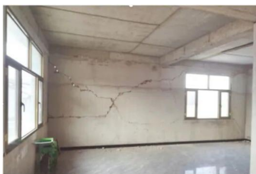
图 8.1.3-1 砌体结构裂缝
