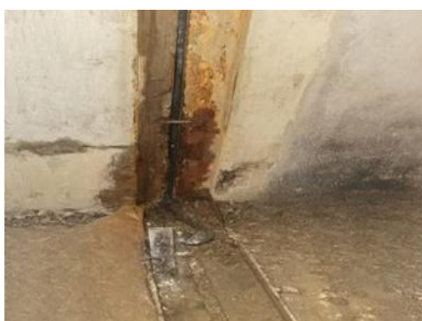
图 3.4.4-1 连通口变形缝渗漏
