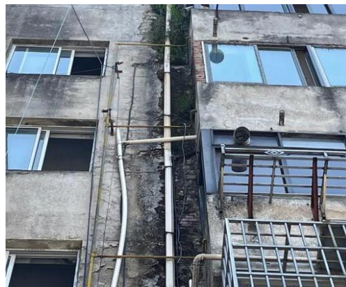
图 6.1.3-2 雨水立管堵塞外溢
