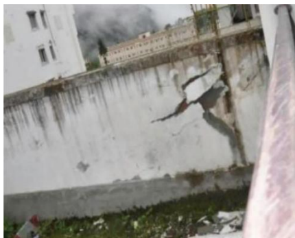
图 8.2.4-1 屋面女儿墙裂缝
