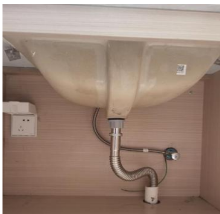
图 5.1.1-1 台盆水封高度不足
