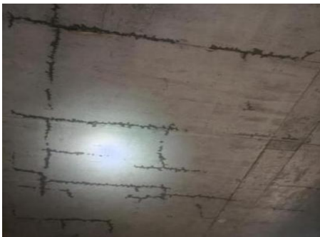
图 8.1.1-1 楼板跨中裂缝
