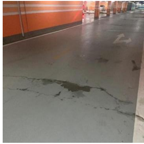
图 7.1.1-2 地面裂缝渗漏
