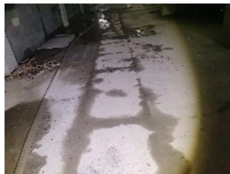
图 3.4.1-2 地下室底板结构开裂渗漏
