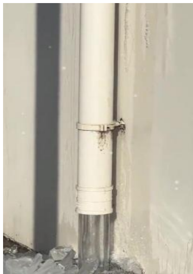
图 6.1.2-1 室外管道受冻堵塞
