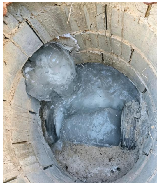
图 2.1.2-2 室外井道冻堵
