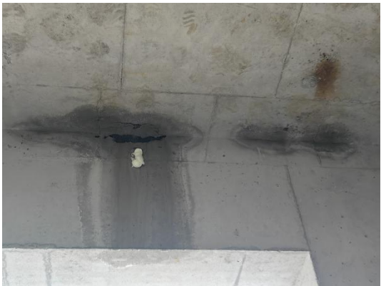
图 3.3.5-2 屋面女儿墙渗漏至室内
