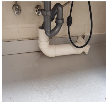
图 5.1.1-2 排水管管口未密封
