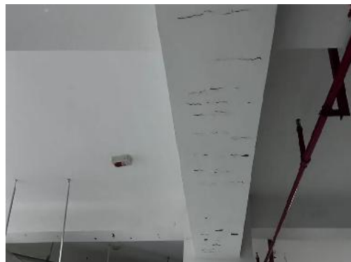
图 4.1.5-2 梁底钢筋锈胀
