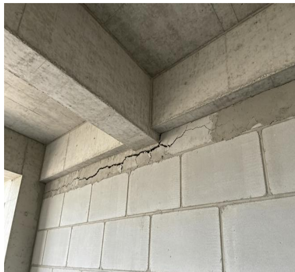
图 4.4.1-2 梁底砌体灰缝裂缝
