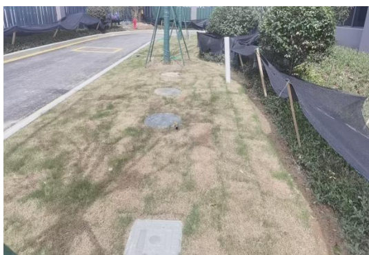
图 5.3.1-1 化粪池通气管高度不足返臭
