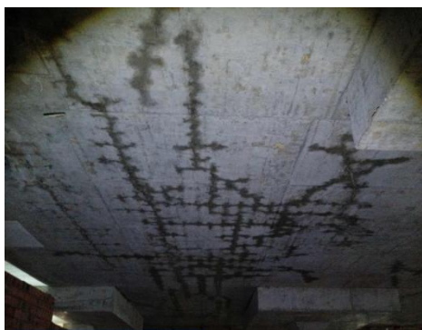
图 3.4.3-1 地下室顶板渗漏
