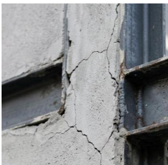
图 4.7.2-1 钢结构住宅接头部位裂缝
