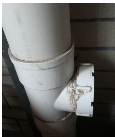
图 9.1.4-1 立管检查口渗漏返臭
