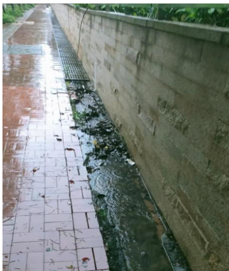
图 6.4.2-1 室外排水沟堵塞积水
