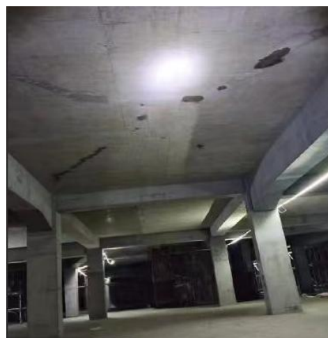
图 4.2.3-2 结构顶板斜角裂缝
