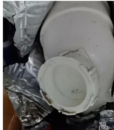
图 5.1.5-2 顶棚支管检查口破损
