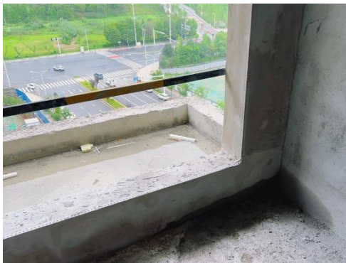
图 3.2.4-1 阳台反坎部位渗漏
