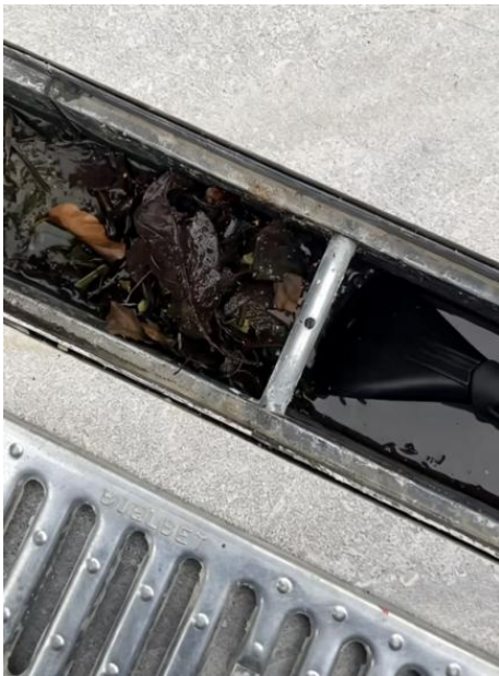
图 2.3.2-1 排水沟内淤积
