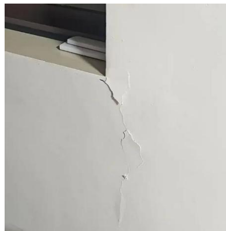
图 4.4.2-2 窗洞口角部裂缝
