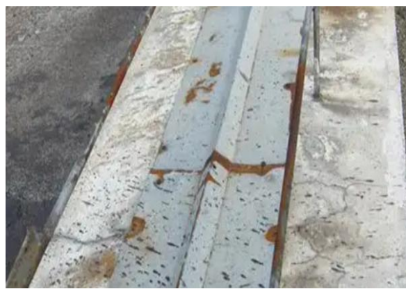
图 4.3.2-2 屋面金属变形缝裂缝
