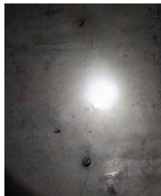
图 4.2.2-2 地下室外墙收缩裂缝
