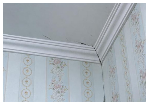
图 8.4.6-2 吊顶转角处裂缝
