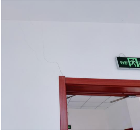
图 8.3.2-1 门洞口角部裂缝
