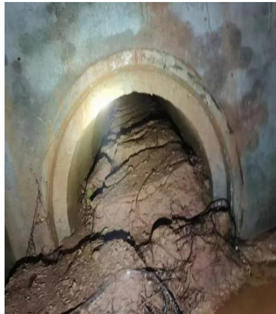
图 6.4.1-2 室外雨水管淤积堵塞
