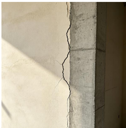
图 4.4.1-1 填充墙与构造柱交接处 界面裂缝
