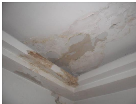
图 3.3.1-2 屋面顶棚渗漏起皮脱落
