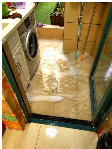
图 6.2.3-2 洗衣房立管堵塞反溢
