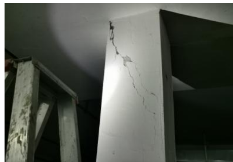
图 8.1.1-4 框架柱斜裂缝
