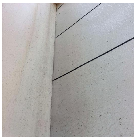
图 8.4.7-2 贴外墙附设管井与墙体交接处裂缝（局部）
