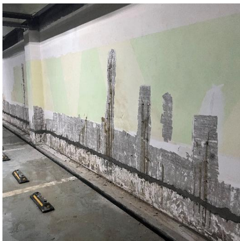
图 7.1.2-1 地下室墙板渗漏
