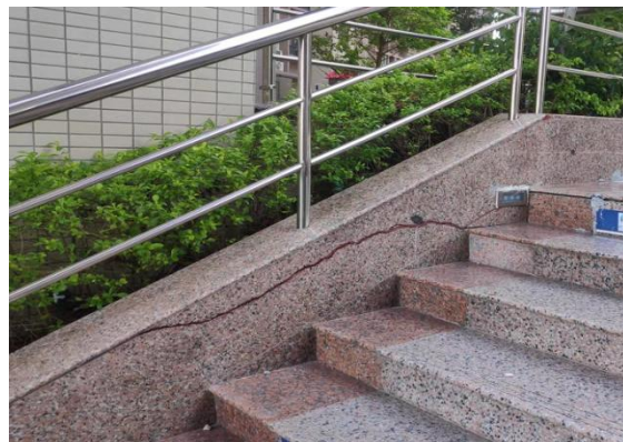
图 8.5.3-2 室外楼梯侧面不规则裂缝
