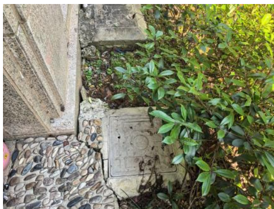
图 5.3.2-2 污水井沉降破损导致绿化土体污染返臭
