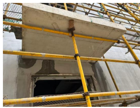
图 3.2.4-2 挑板构件交接部位渗漏
