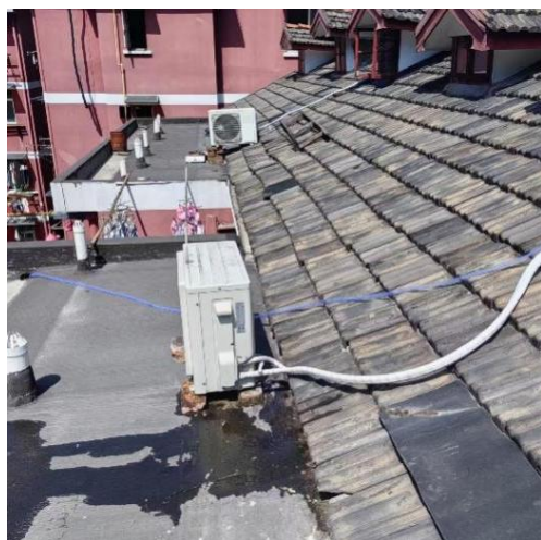
图 7.2.2-1 砖木结构瓦破损渗漏
