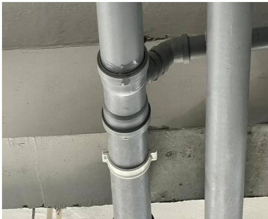
图 5.1.5-1 顶棚支管接口渗漏
