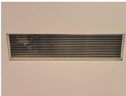
图 5.2.1-1 空调回风口污垢过多
