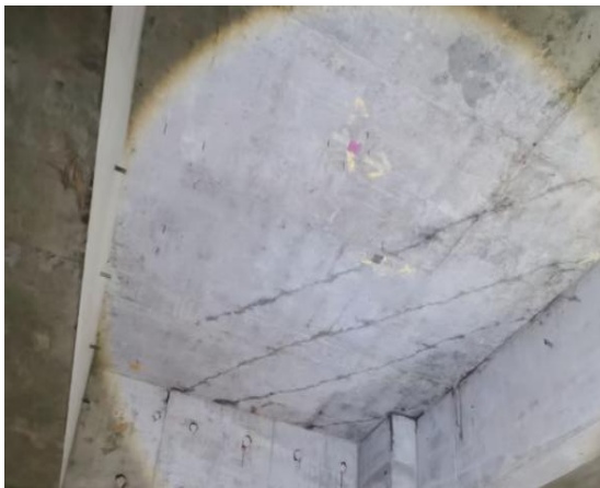
图 4.1.1-1 板角斜向裂缝
