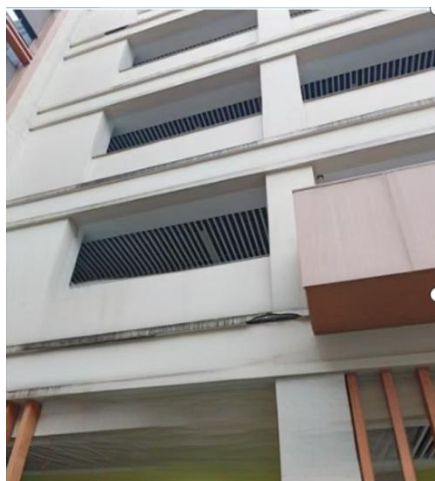
图 4.5.5-1 外墙装饰线条断裂
