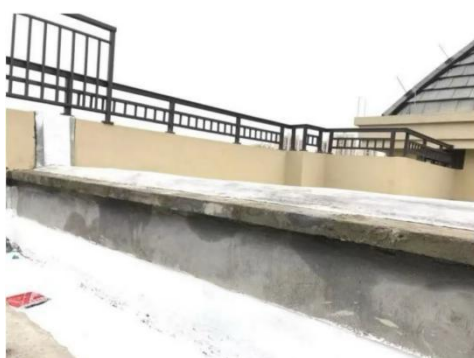
图 3.3.2-1 屋面变形缝渗漏
