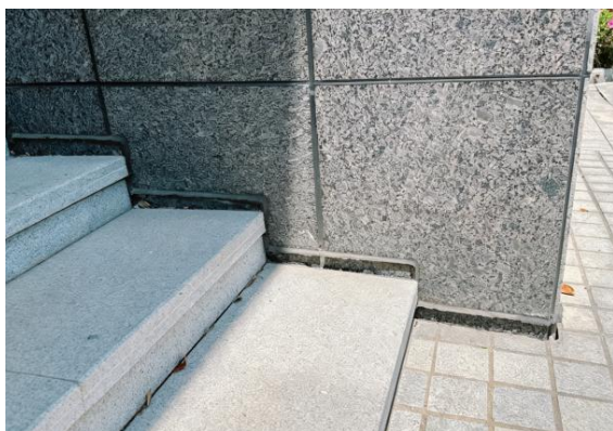
图 8.5.3-1 室外踏步与墙体交接处裂缝
