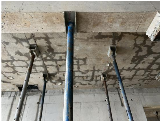
图 3.1.1-1 涉水房间结构板中渗漏
