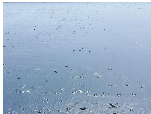
图 3.1.4-2 防水层施工不到位
