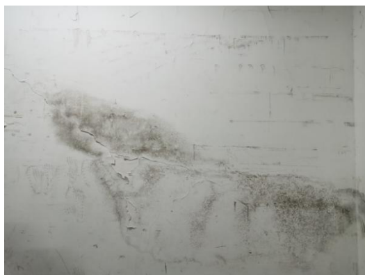
图 8.4.2-1 抹灰层大面空鼓和开裂
