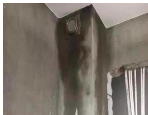
图 3.1.3-2 厨房烟道渗漏
