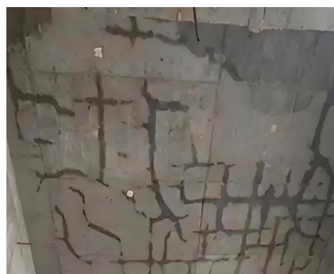
图 4.3.1-2 屋面结构板裂缝
