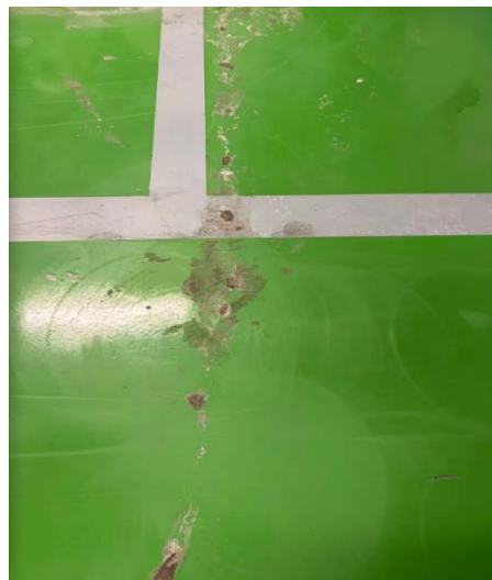
图 4.5.7-2 环氧地坪裂缝
