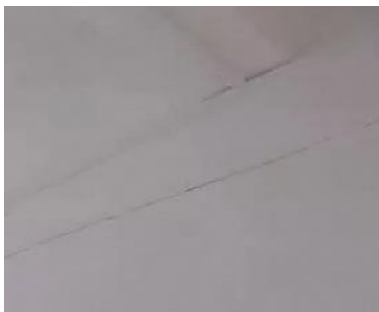
图 4.4.3-1 填充墙墙体水平裂缝
