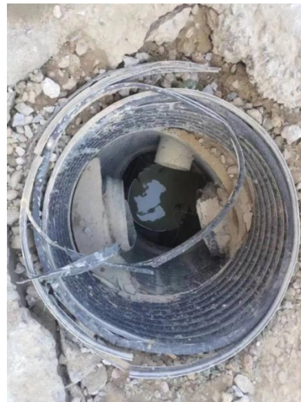
图 2.3.1-2 雨水管挤压变形
