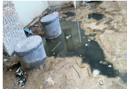
图 3.5.4-2 室外检查井与管道渗漏
