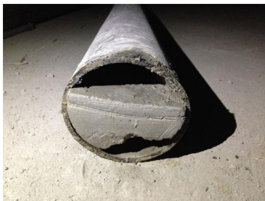
图 6.1.3-1 雨水立管堵塞
