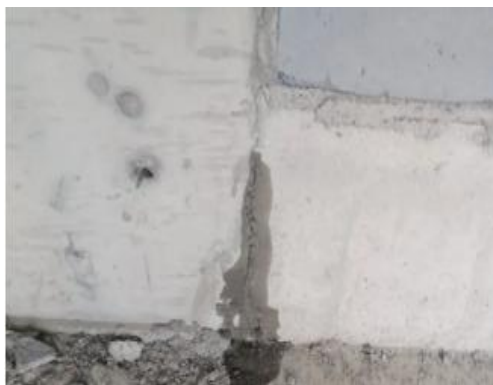
图 3.1.2-1 卫生间翻边渗漏
