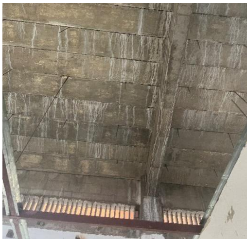
图 7.2.1-1 多孔板间裂缝渗漏
