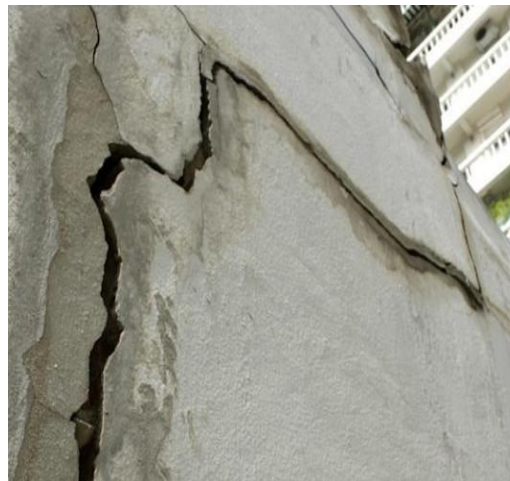
图 4.5.5-2 贴外墙附设管井裂缝
