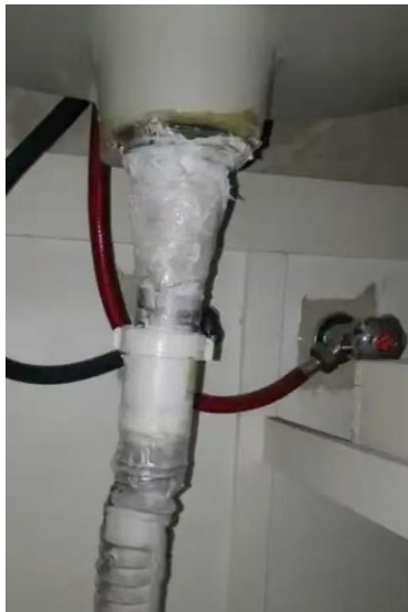
图 9.1.1-1 台盆排水构件未封闭
