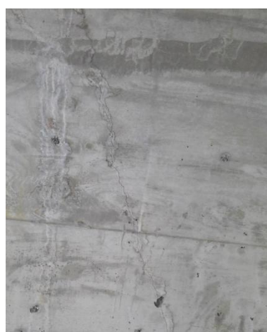
图 4.1.4-2 剪力墙裂缝（局部）
