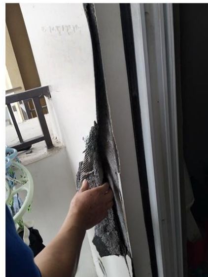
图 4.5.6-2 外墙保温层剥落
