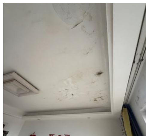
图 7.2.3-2 屋面结构板渗漏
