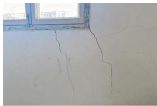
图 8.1.3-2 砌体结构窗口裂缝
