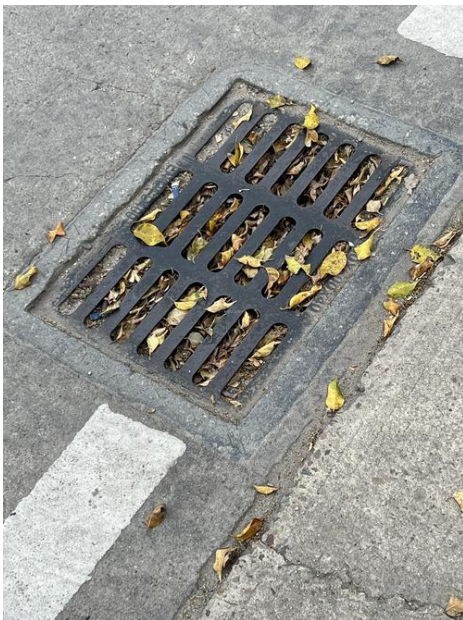
图 6.4.1-1 室外雨水井堵塞
