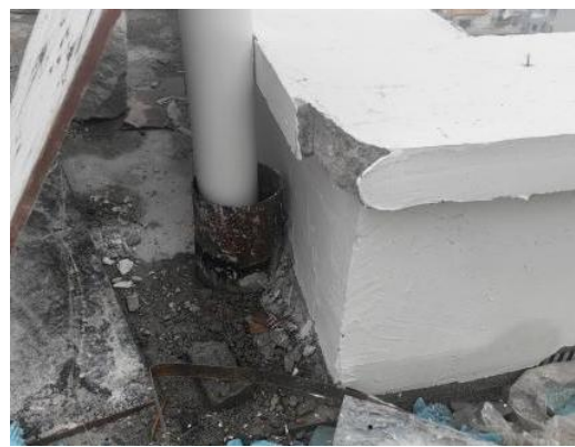
图 3.3.3-2 屋面套管避免留置在排水沟内
