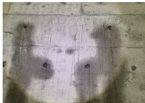
图 3.4.2-2 地下室外墙螺杆洞渗漏
