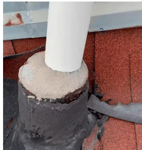
图 4.3.3-2 出屋面管道部位防水层剥离与开裂
