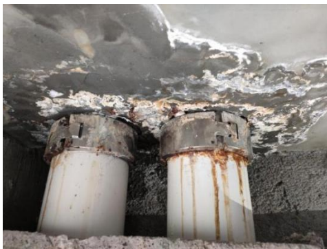
图 3.5.1-1 排水管穿楼板渗漏
