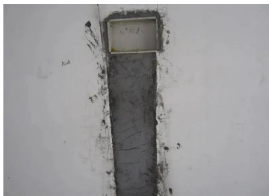
图 4.5.1-1 管线开槽部位抹灰层裂缝
