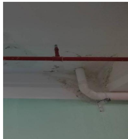
图 7.1.3-2 顶板穿墙管道侧渗漏
