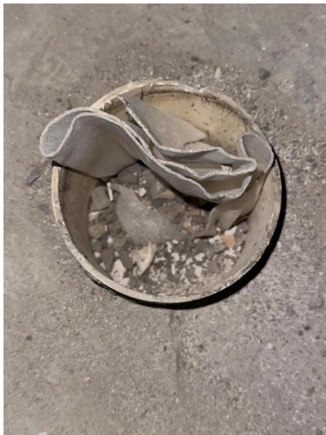
图 2.4.4-1 立管底部建筑垃圾堵塞
