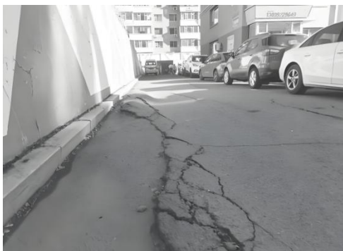
图 8.5.1-1 沥青路面龟裂
