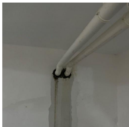
图 7.1.2-2 墙面穿墙套管渗漏
