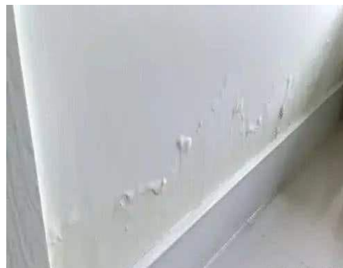
图 3.1.2-2 卫生间侧墙涂料起皮脱落
