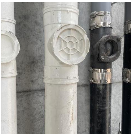
图 5.1.4-1 立管接口渗漏
