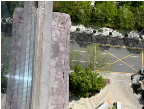
图 8.4.5-1 装饰线条竖向裂缝
