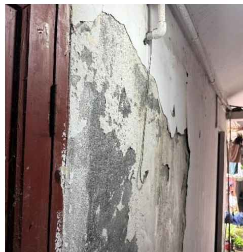
图 7.2.2-2 砖木结构天沟边渗漏
