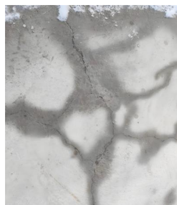
图 4.3.4-2 屋面地坪裂缝
