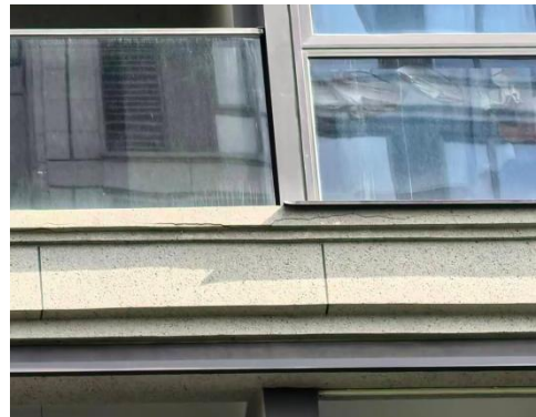
图 8.4.5-2 装饰线条水平裂缝
