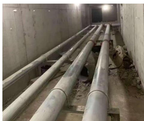
图 5.3.3-2 地下夹层封闭区域通风设施不完善
