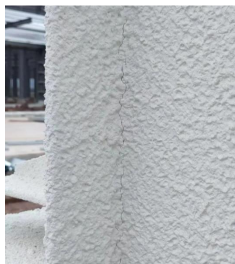
图 4.7.2-2 钢结构住宅涂料裂缝
