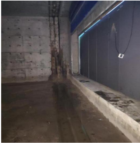
图 7.1.4-1 地下变形缝周边积水
