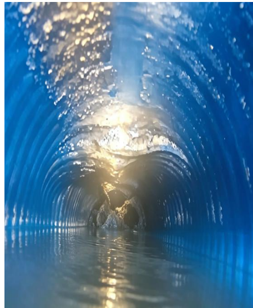
图 2.3.3-2 管道挤压破损
