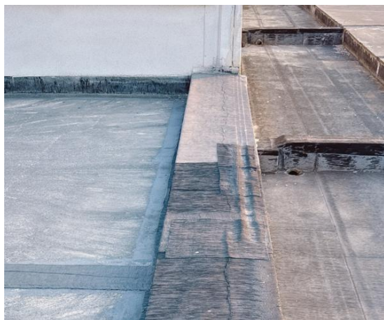
图 8.2.1-1 屋面变形缝盖板开裂
