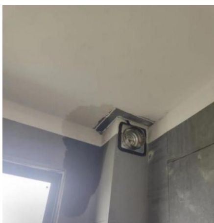
图 7.2.3-1 屋面烟道渗漏
