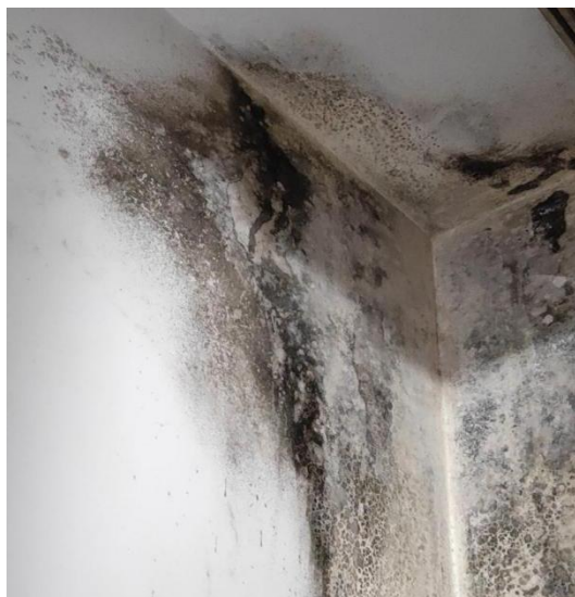
图 9.1.5-1 吊顶、墙面发霉返臭
