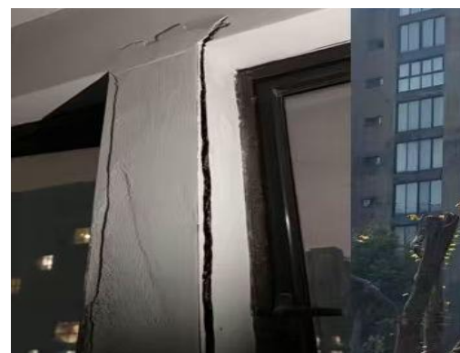
图 4.5.1-2 室内抹灰层裂缝
