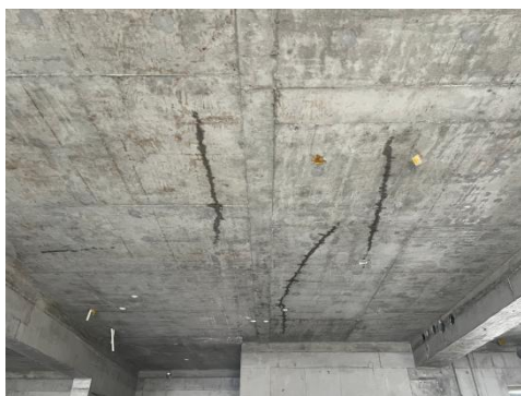
图 3.3.1-1 屋面结构板渗漏
