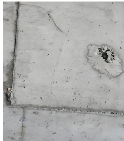
图 4.7.3-2 大跨度阳台裂缝
