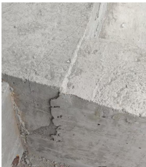
图 4.7.3-1 大跨度阳台根部裂缝
