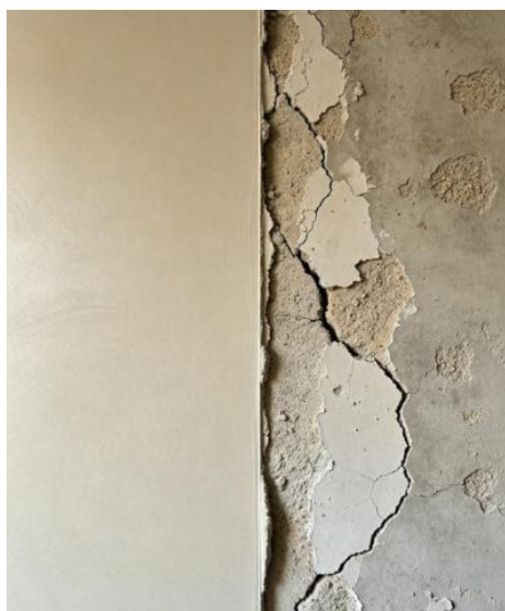
图 8.3.1-1 填充墙与混凝土墙交界 处开裂
