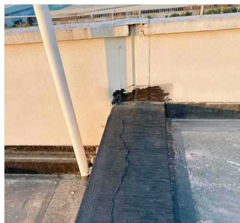
图 8.2.1-2 屋面变形缝盖板开裂
