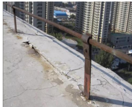
图 8.2.4-2 屋面女儿墙压顶裂缝
