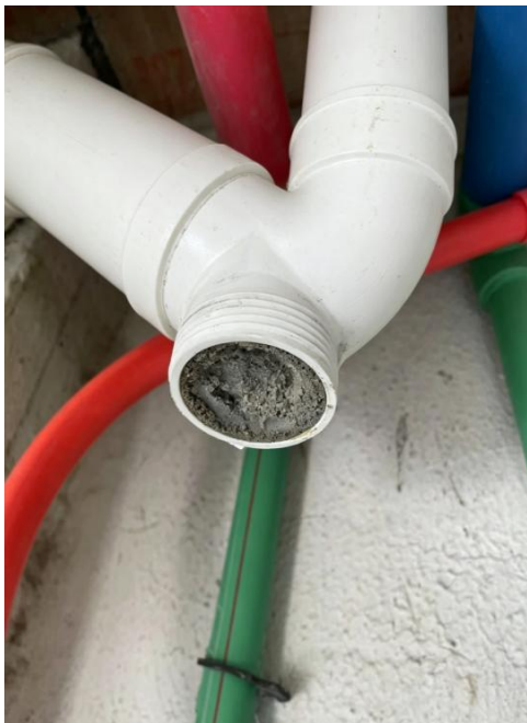
图 2.4.2-1 弯头处建筑垃圾堵塞
