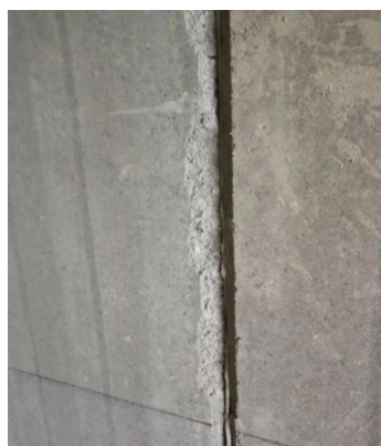
图 4.4.4-1 隔墙竖向接缝裂缝
