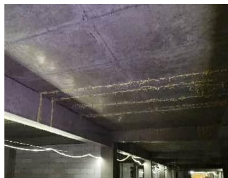
图 3.4.3-2 覆土超荷引发的顶板渗漏
