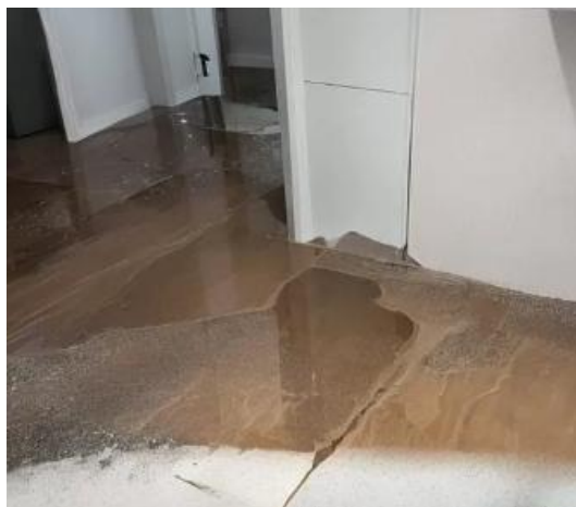
图 9.3.1-1 地暖渗漏发霉
