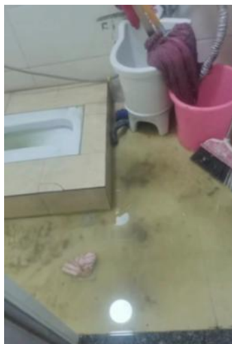
图 6.2.3-1 卫生间立管堵塞反溢
