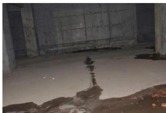
图 4.2.1-2 底板跨中渗水贯穿缝
