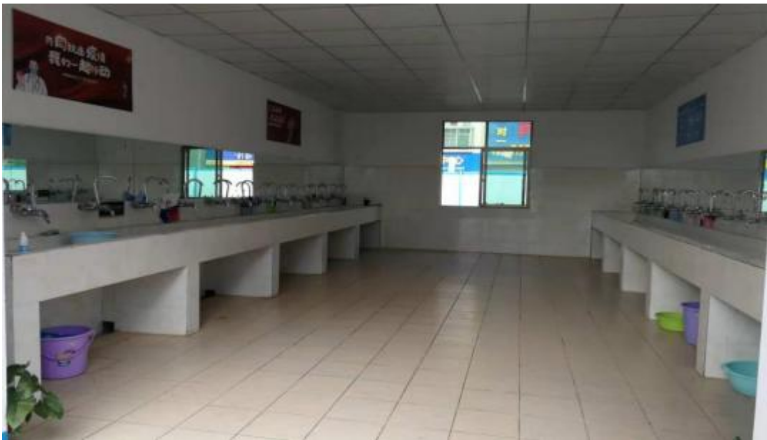
室内盥洗室实景图
