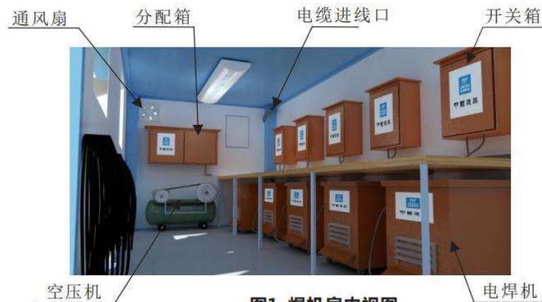
图1 焊机房内视图
