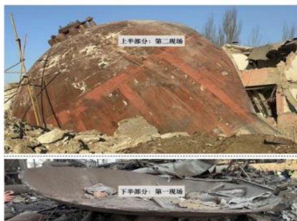
图 16 球罐沿下环焊缝开裂后现场图
