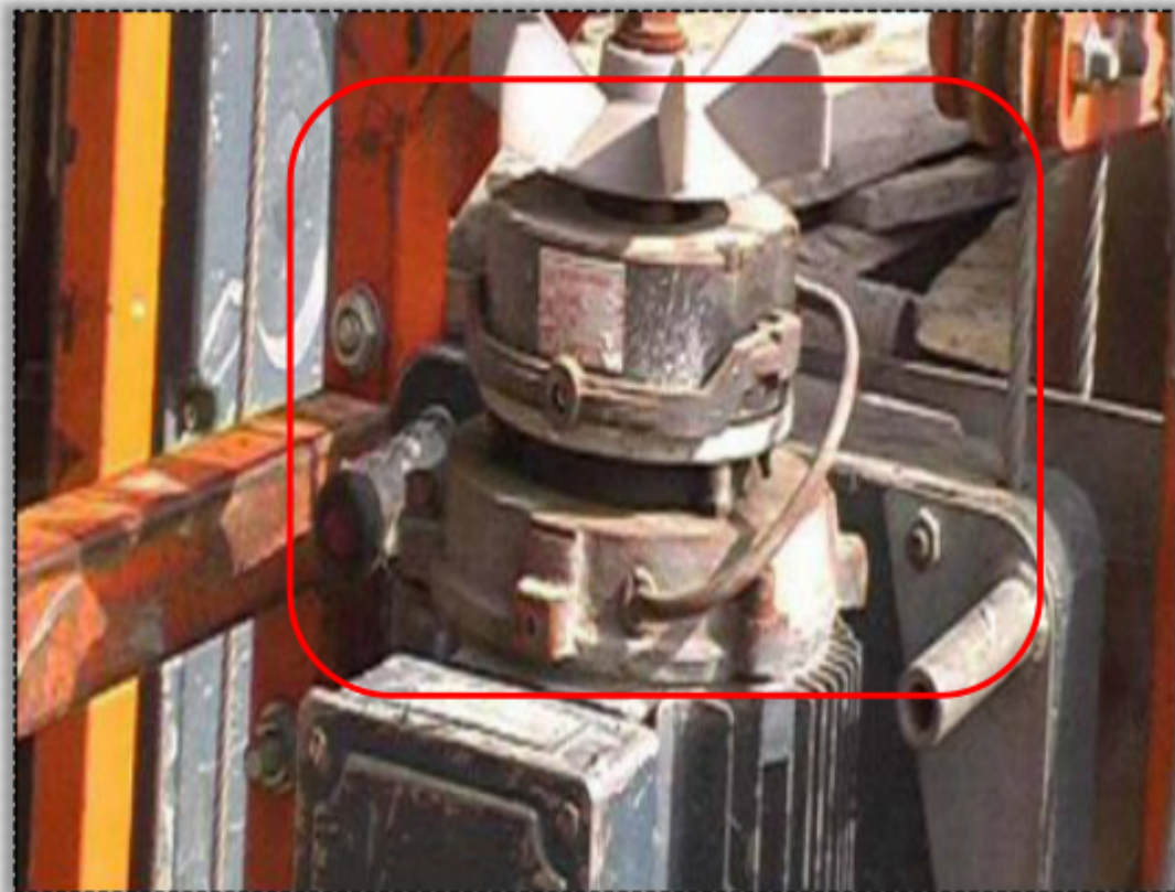
提升机防护罩缺失
