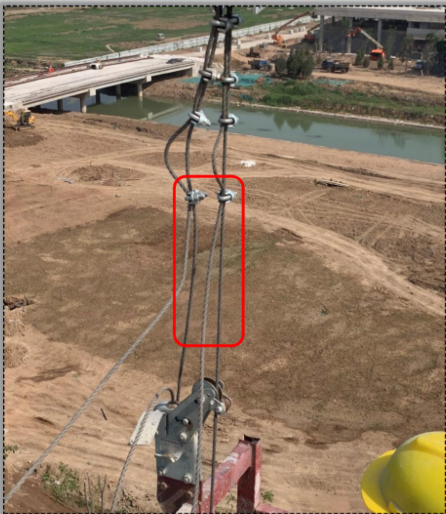
上限位挡板缺失或损坏
