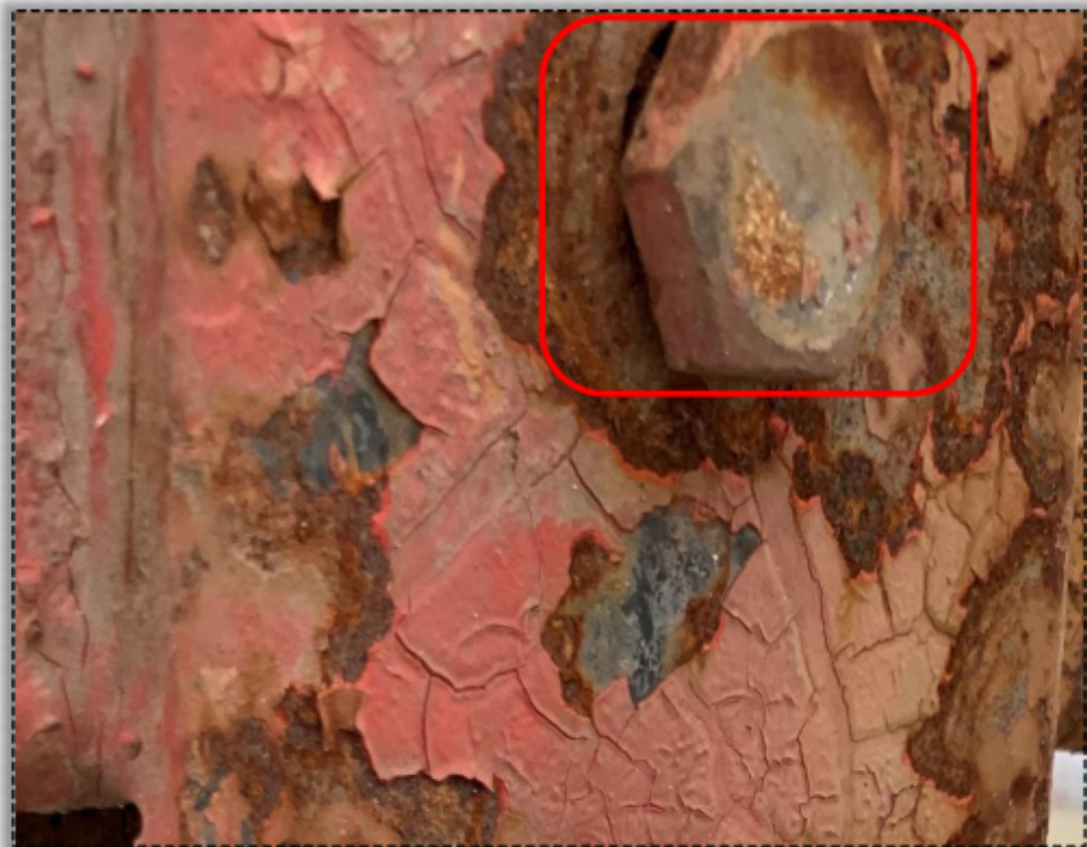
吊篮构件锈蚀严重
