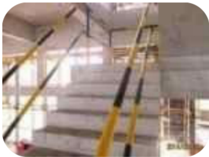
楼梯平台和梯段边防护
