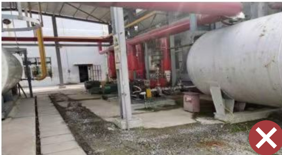
导热油炉周围未设置围堰
