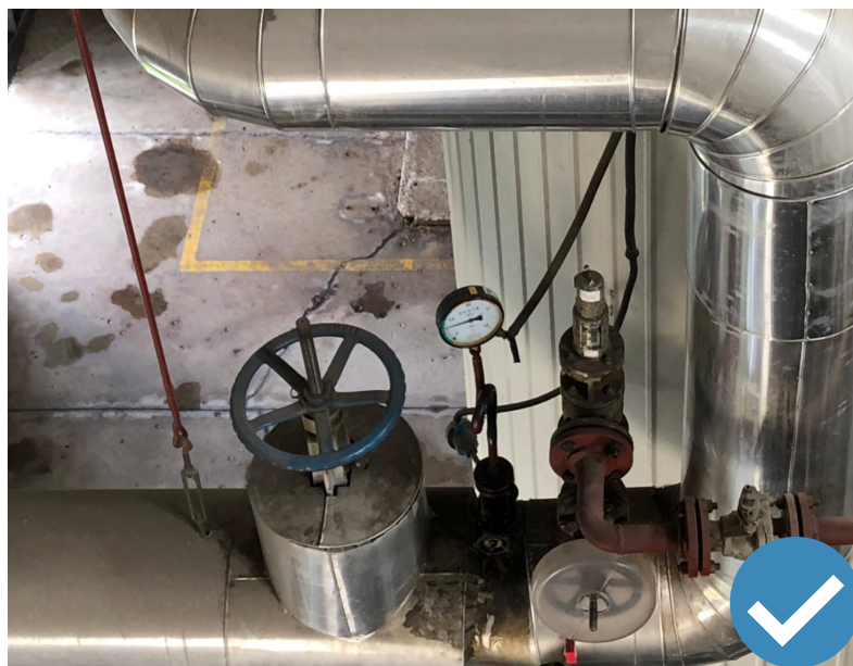
安全阀、压力表等安全附件正常投用
