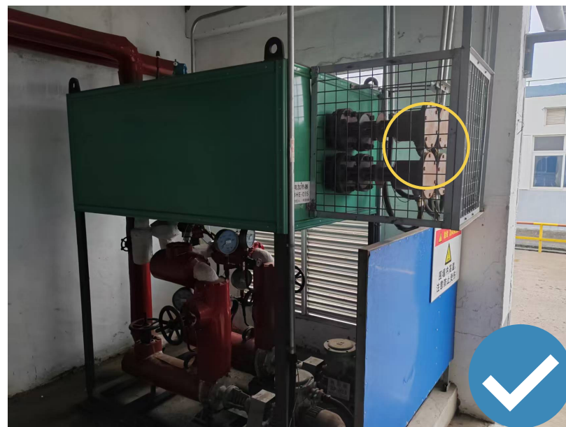
接线盒无保温覆盖
