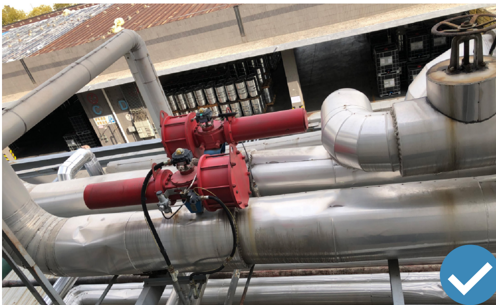
导热油管道进入生产设施处设置紧急切断阀
