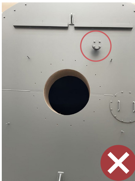
加热炉未配备紧急灭火装置
