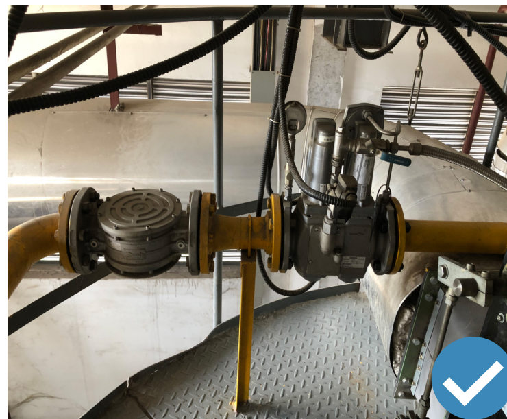
燃烧器设置漏气检测装置
