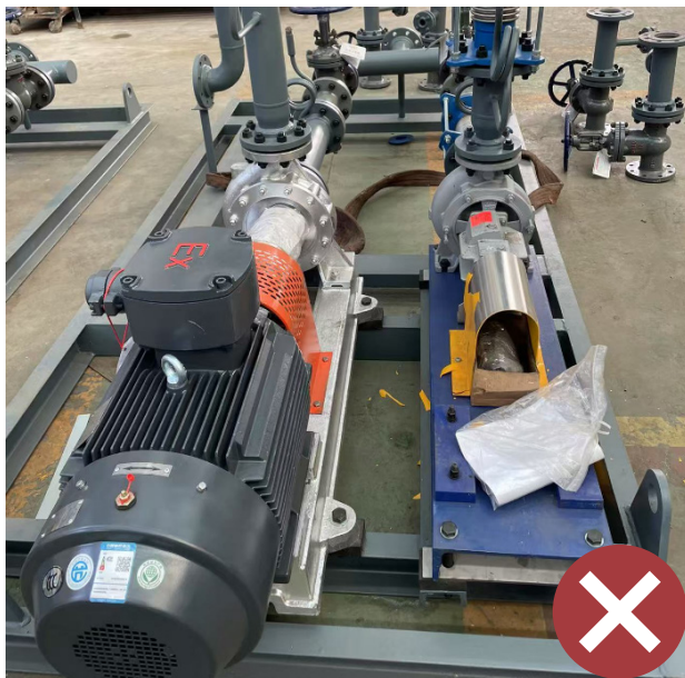
循环泵配备不足
