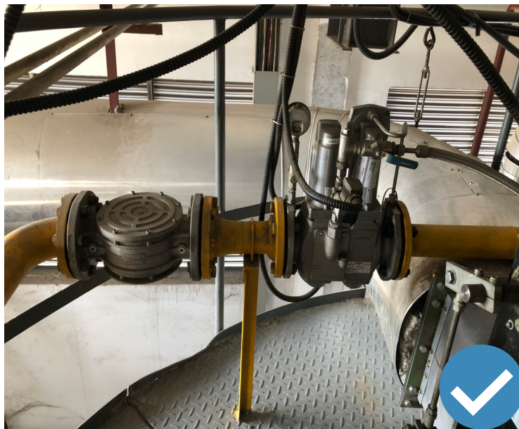
燃气导热油炉燃烧器设置检漏装置
