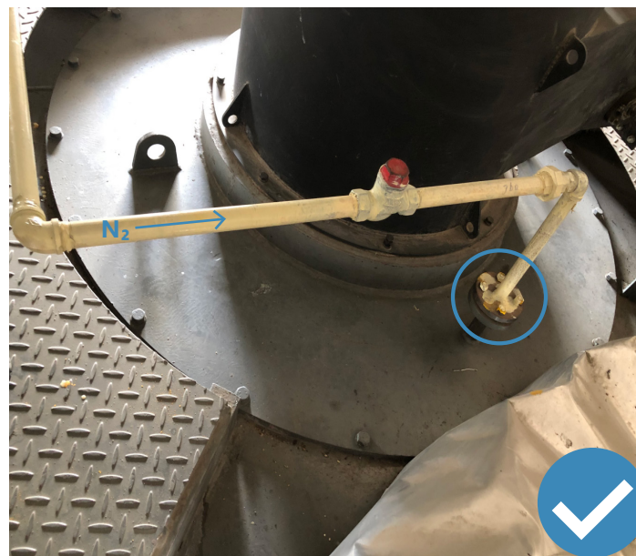
加热炉配备氮气或蒸汽灭火装置
