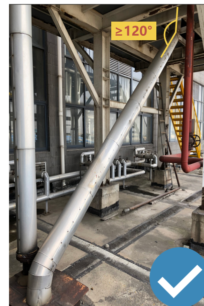
膨胀管上无阀门且弯曲角度不小于120°
